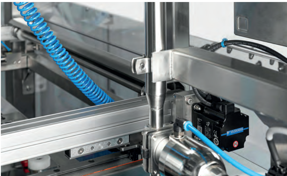
Uno dei requisiti chiave è stata la capacità di supportare sia Profinet che Ethernet/IP. One of the key requirements was the ability to support both Profinet and Ethernet/IP.
