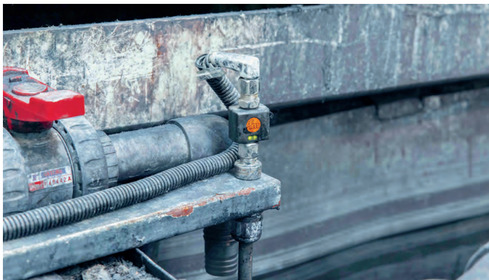
Sonda di temperatura, convertitore del segnale di misura e cavi nel processo di anodizzazione. Temperature probe, evaluation unit and cables in the anodisation process.
